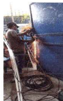
Foto 4: Sustitución de chapa en puertas de metal en el establecimiento
